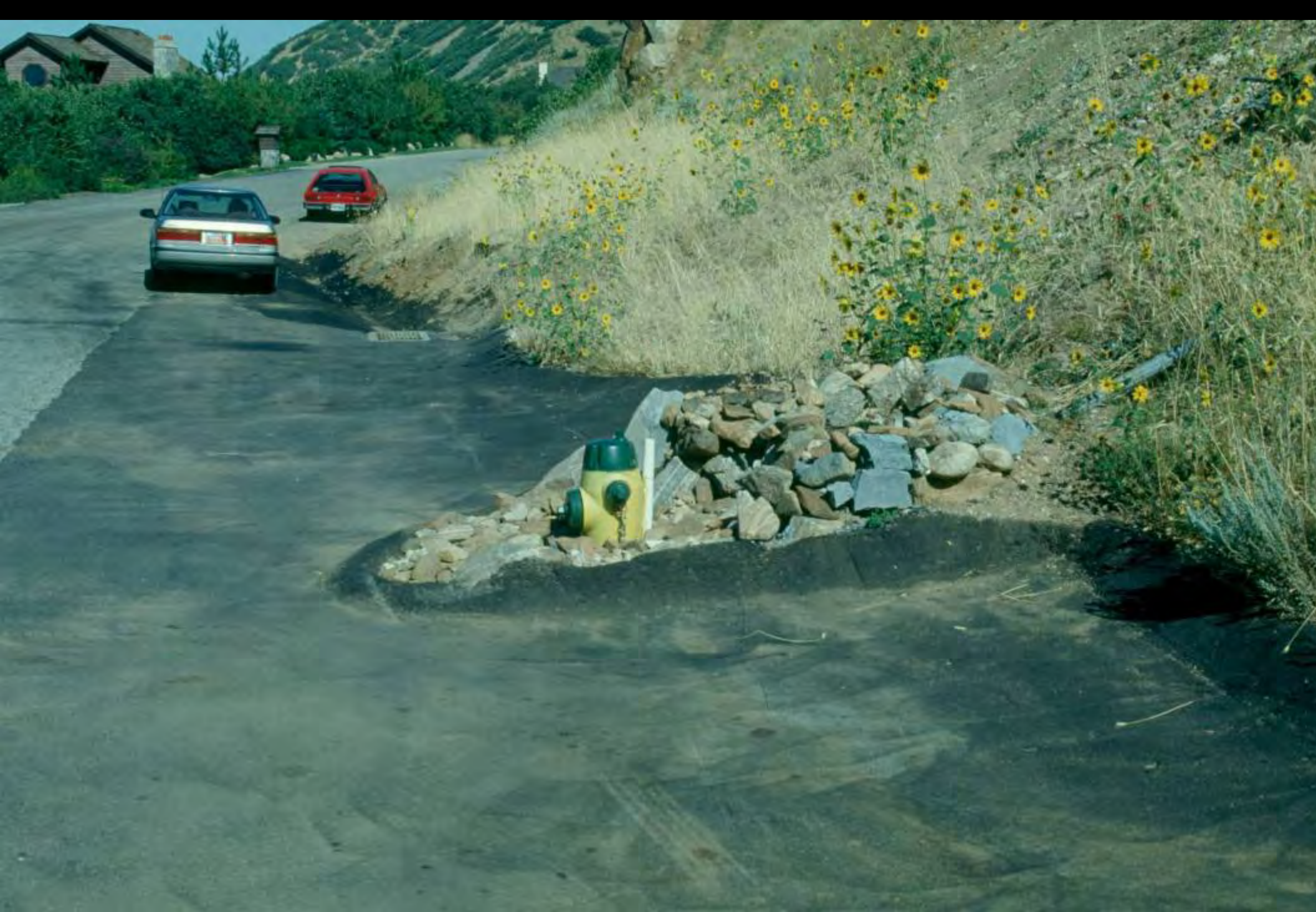
Hydrant (buried; Uintah, UT)
